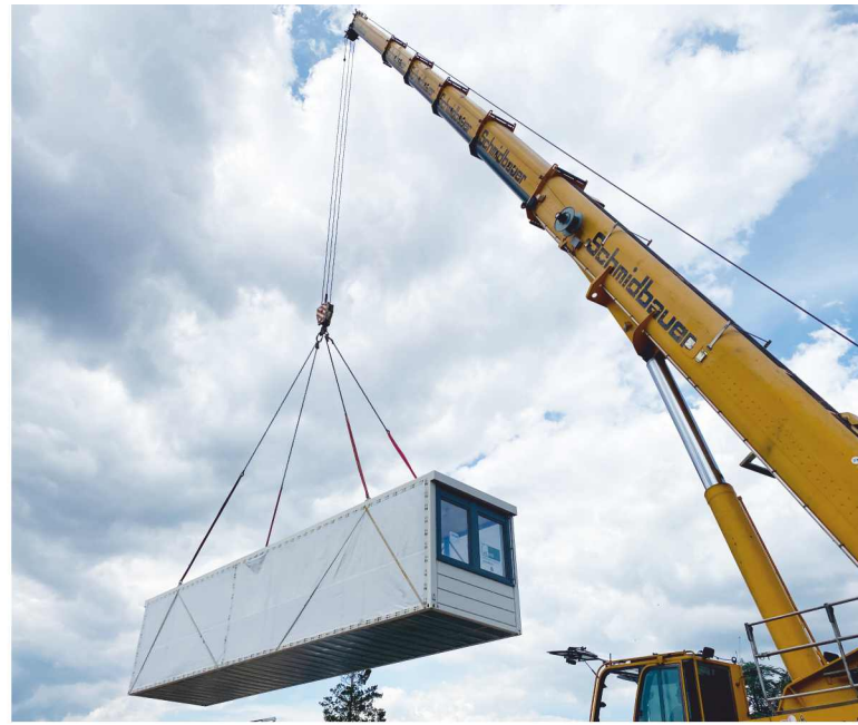
Die Container für die neue Kita in Stein schweben ein. Foto: Stadt Stein
