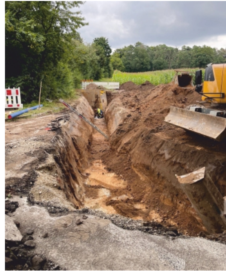
Blick in den offenen Leitungsgraben der Verbundleitung an der B 14. Foto: Wasserzweckverband Großweismannsdorf
